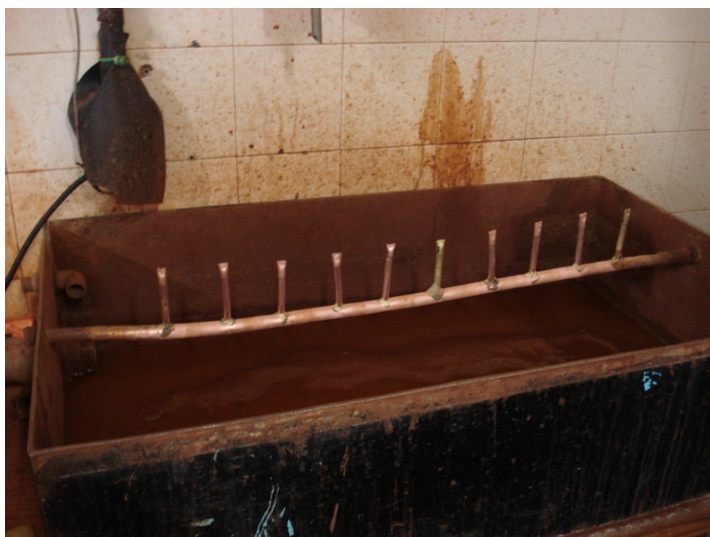
Figura 43: lavadores com bicos para lavagem de recipientes no antigo laboratório
